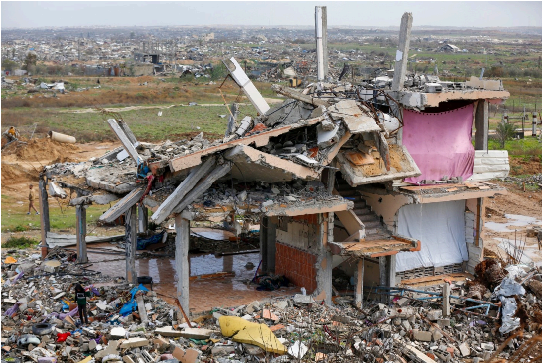
منزل مدمر في النصيرات، المناطق الوسطى بغزة. شباط 2025. الحقوق محفوظة للأونروا، 2025. تصوير أشرف عمرة
